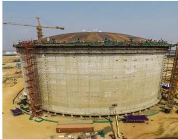
Lateral view of LNG Storage tank.
